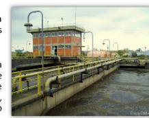
Estação de tratamento de esgoto
